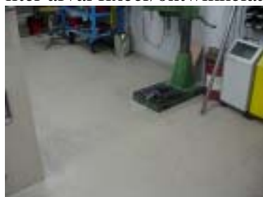
Vloeistofdichte vloer Mechanische TD
