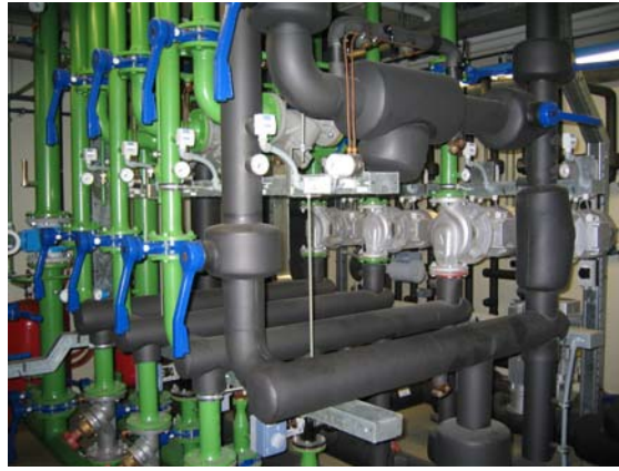
Technische ruimte Commanderpers
