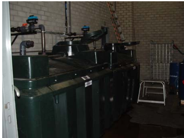
Opslagtanks voor afgewerkte CtP-chemie
